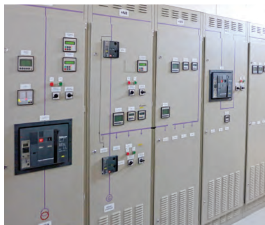
Industrijski energetski niskonaponski razvod
