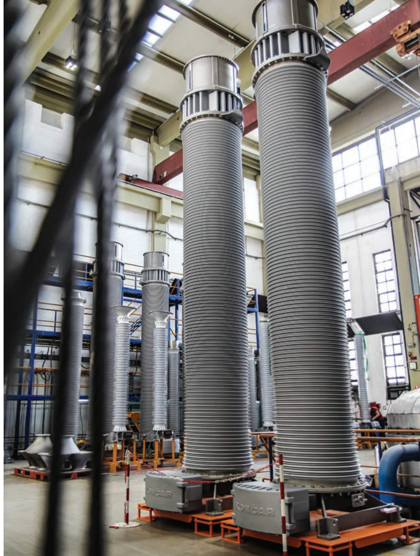
Transformator za vlastito napajanje trafostanica naponskog nivoa 525 kV
