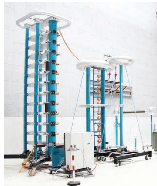
VN laboratorij u Distributivnim i specijalnim transformatorima
