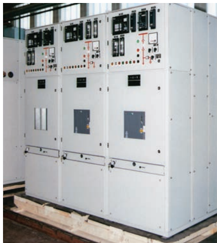
Sredjenaponski sklopni blokovi
